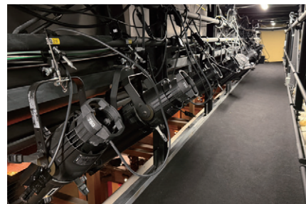
第1シーリングライト
