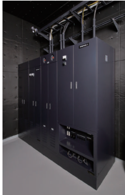
舞台上手に設置された電源盤
