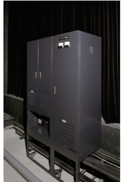
サイドギャラリに設置された電源盤
