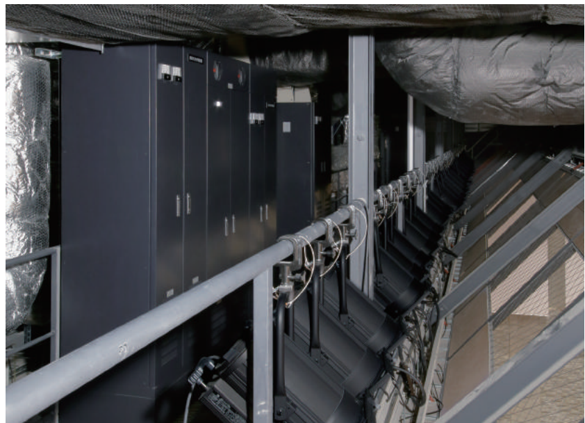
第1シーリングライトに設備された電源盤
