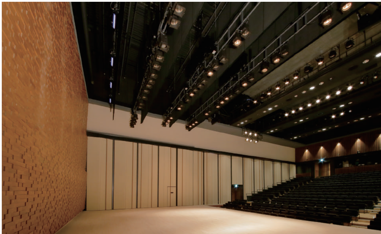
舞台上部と観客席上部の照明設備
