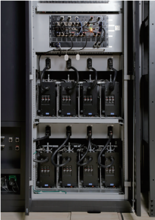
照明機器電源盤に収納された移動型調光器
