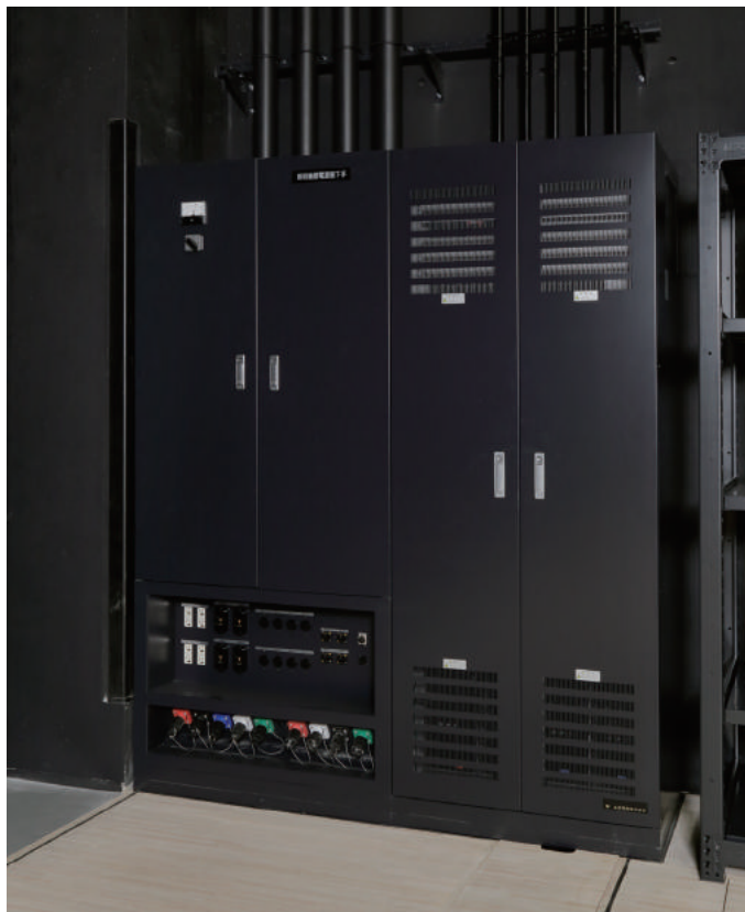
舞台下手後に設備された電源盤
