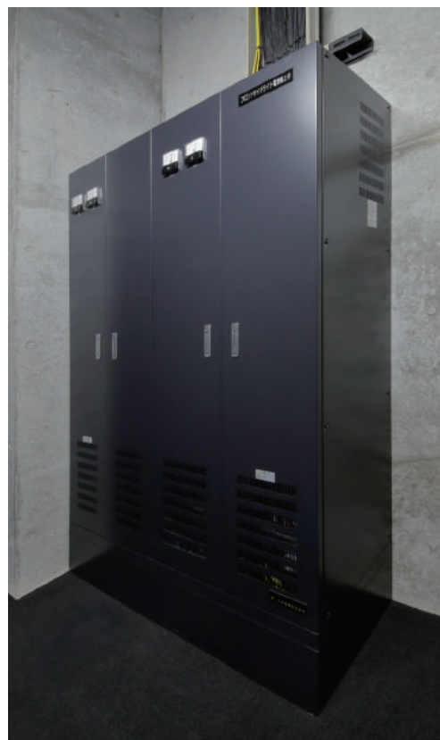
上手フロントサイドに設備された電源盤
