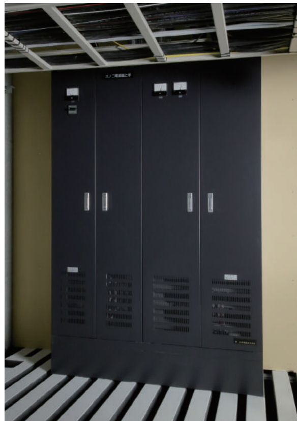
スノコに設備された電源盤
