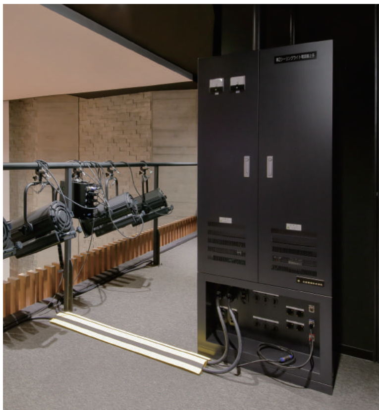
第2シーリングライトの上手に設備された電源盤
