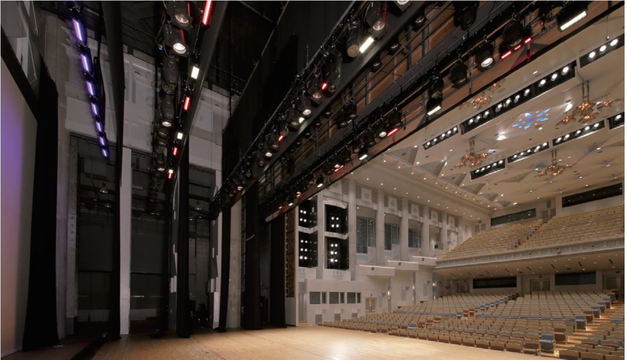
LED 照明機器が導入されたコンサートホールの舞台照明設備
