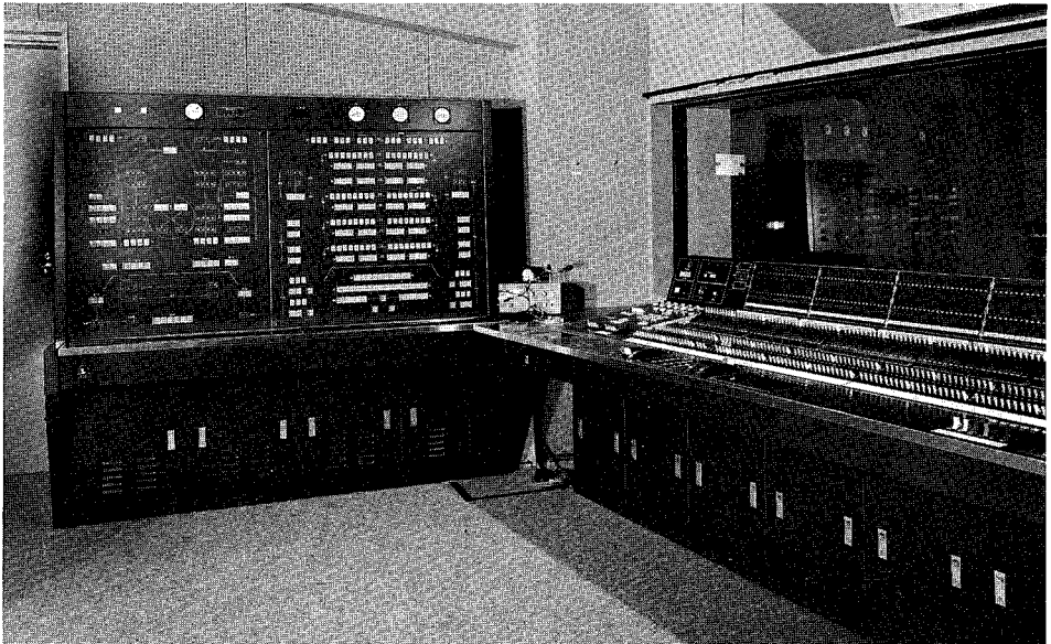
中ホール調光室の照明操作卓と電子クロスバー選択操作盤
