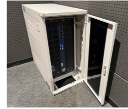
ピンスポットライト室 ネットワーク中継ボックス
