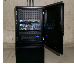
舞台袖 ネットワーク中継ラック
